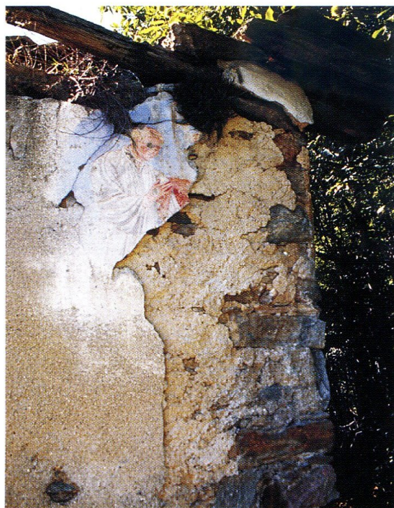
90. Fobe - San Luigi Gonzaga [?]. L'intonaco si è sgretolato nel 2003 e la pittura non è più visibile.
